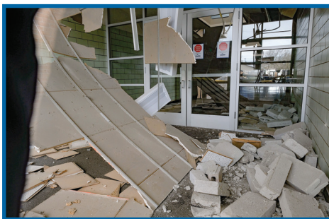
Escombros en la entrada de West Lake Junior High School en Saratoga Springs después del terremoto de 2020 en Magna, Utah. Foto cortesía de Francisco Kjolseth, The Salt Lake Tribune.
