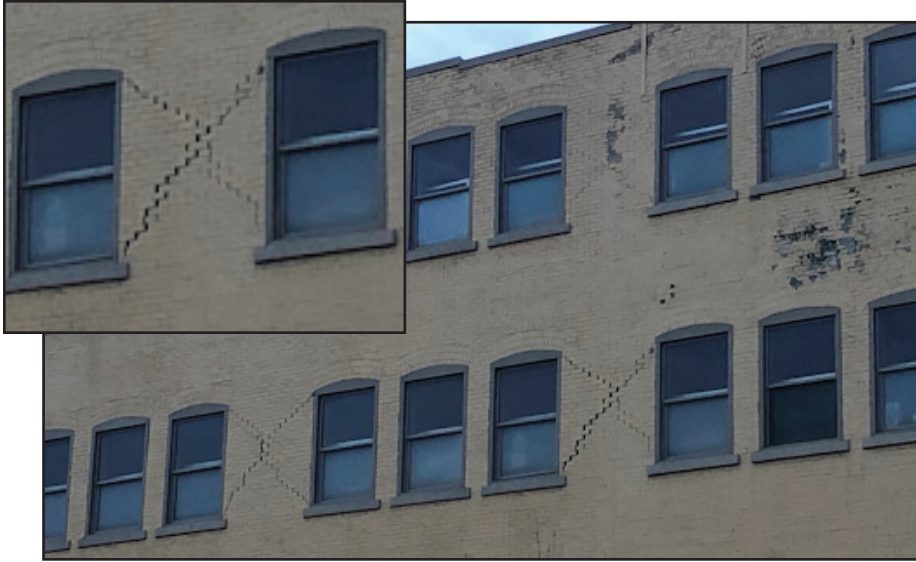
Daños a un edificio URM en el centro de Salt Lake City por el terremoto de Magna de 2020. El patrón "X" entre las ventanas arqueadas es un signo revelador de la construcción de URM. Este es un ejemplo de ruptura "en el plano". Foto cortesía de Reaveley Engineers.
