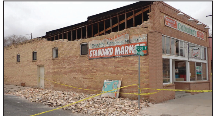
Daño estructural a un edificio de mampostería no reforzada en el centro de Magna causado por fuertes sacudidas del suelo por el terremoto de Magna. Foto cortesía del Servicio Geológico de Utah.
