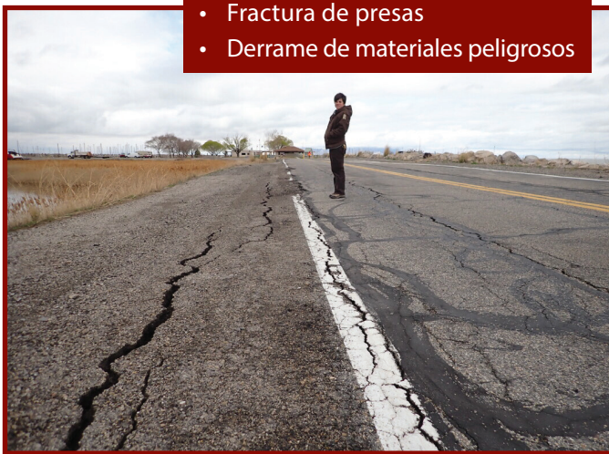
Grietas y daños en la carretera a lo largo del acceso a la Marina del Great Salt Lake probablemente ocasionadas por el terremoto de Magna 2020 M 5.7, Utah. Foto cortesía del Servicio Geológico de Utah.
