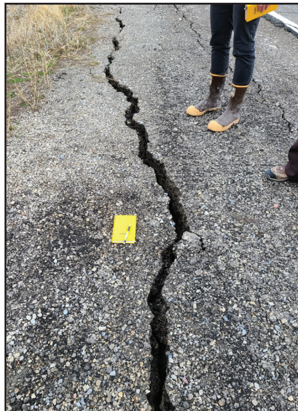
Grieta lateral del suelo a lo largo de la carretera de acceso a la Marina del Gran Salt Lake desde el terremoto de Magna. Foto cortesía del Servicio Geológico de Utah.
