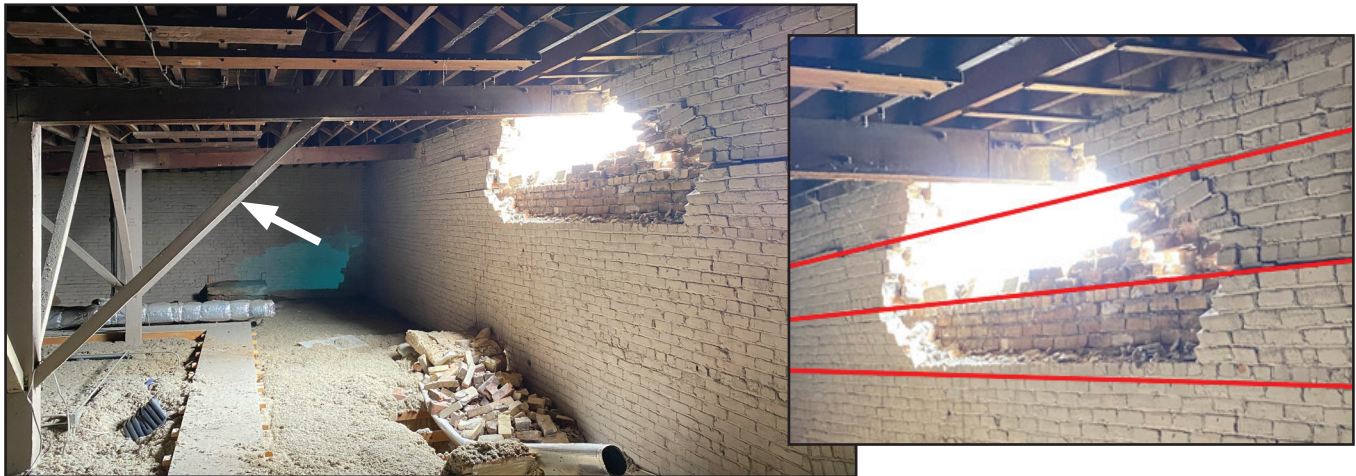
Daños a un edificio URM en el centro de Salt Lake City por el terremoto de Magna de 2020. La imagen muestra ladrillo sin reforzar con cursos de cabecera (líneas rojas). La pared tiene daños de mampostería fuera del plano. La abrazadera diagonal era lo suficientemente fuerte como para soportar la viga del techo evitando el colapso del marco del techo. Foto cortesía de Reaveley Engineers.
