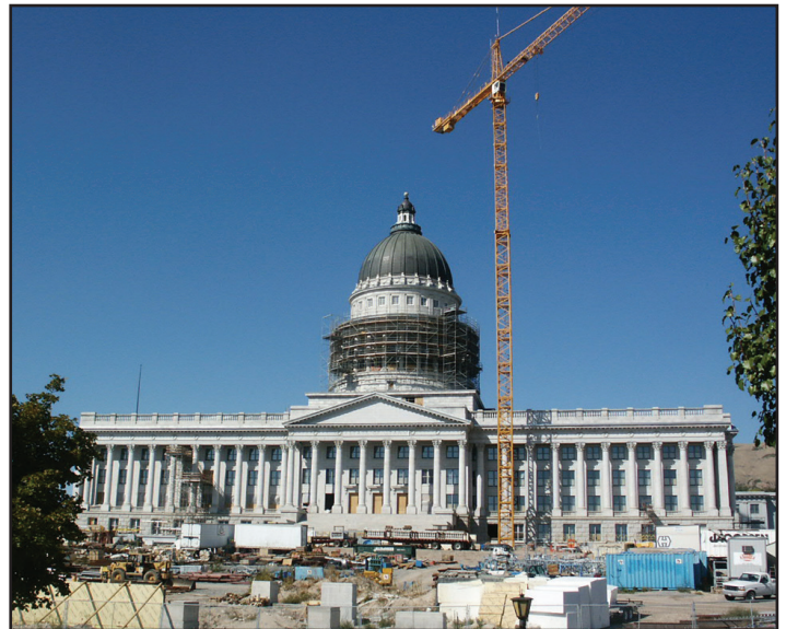
El Estado de Utah renovó el edificio del Capitolio para preservar un edificio histórico y garantizar la seguridad pública y la continuidad del gobierno en caso de un gran terremoto. El edificio del Capitolio descansa sobre un sistema de 265 aisladores de base sísmica, separando el edificio de los cimientos y disminuyendo los efectos de la sacudida del terremoto. Foto tomada el 24 de septiembre de 2006, cortesía del Servicio Geológico de Utah.
